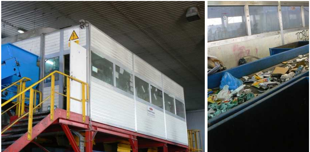
Fot. 2,3. Kabina i linia sortownicza (fot. S. Kowalska)
