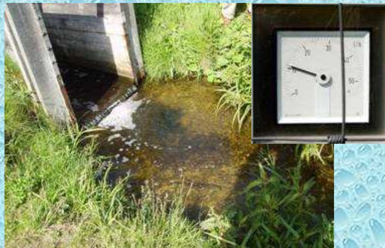
Odpływ z oczyszczalni
