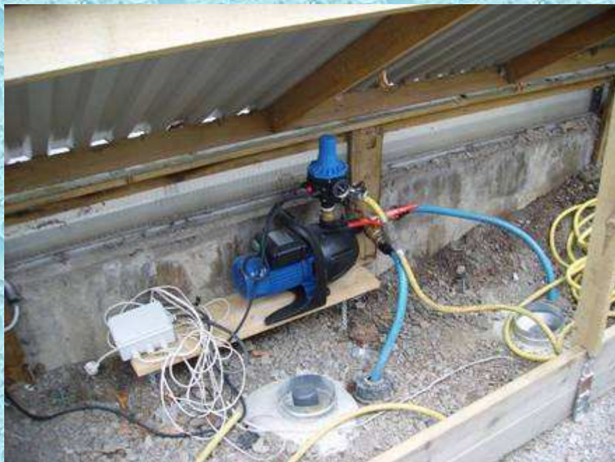
Zbiornik na mocz oraz pompa zasilająca układ podlewania
