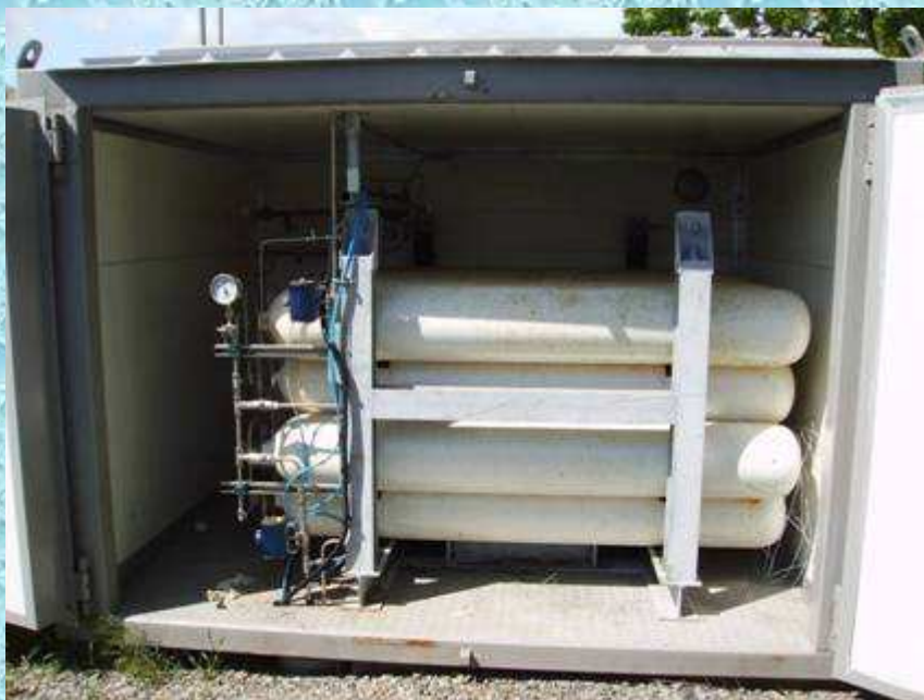
Zbiorniki ze sprężonym biogazem
